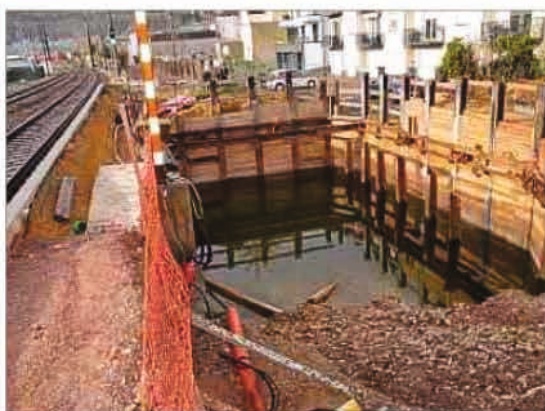
Der zukünftige Zugang zur Unterführung ähnelt derzeit eher einem Fischweiher. Foto: Frank Weyrich
